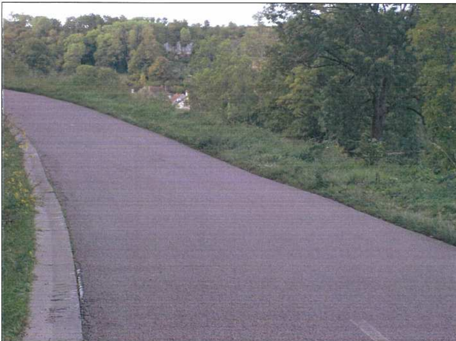
Figure 12: Chaussée déformée dans une zone de glissement actif au sud d'ORCHES.
