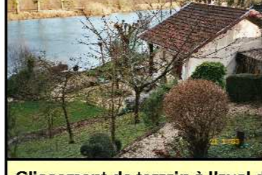
Glissement de terrain à l'aval de la RD35a. Terrain chahuté, une maison est concernée par le phénomène.
