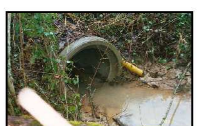
Busage Ø800 du ruisseau de chausségne. Le lit du ruisseau est très encombré à l'amont, le risque d'embâcle est donc important.
