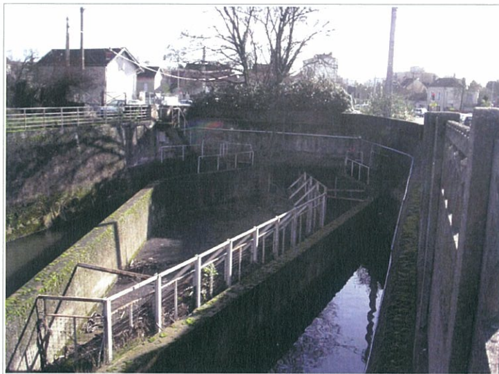
Couverture du Suzon, on notera sa complexité, ce qui peut nuire au transit des crues, notamment en cas d'embâcles.
