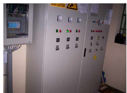
Armoire de Commande
