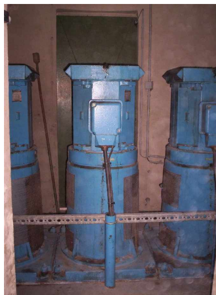
Moteur des groupes à ligne d'arbres
