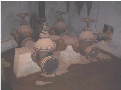
Chambre de Vannes
