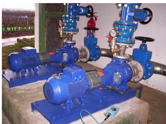
Groupes de Pompages
