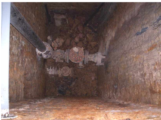
Chambre de Vannes
