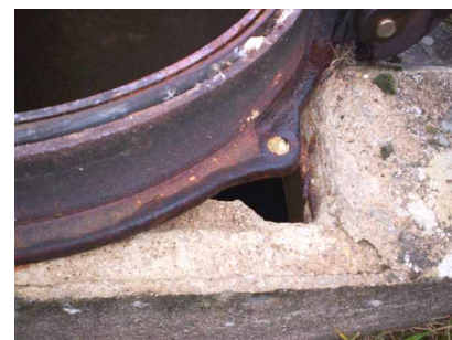
Tampon d'Accès Cuve
