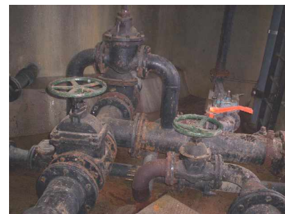
Chambre de Vannes
