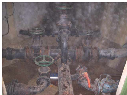
Chambre de Vannes
