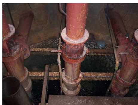
Puits et pompes immergés
